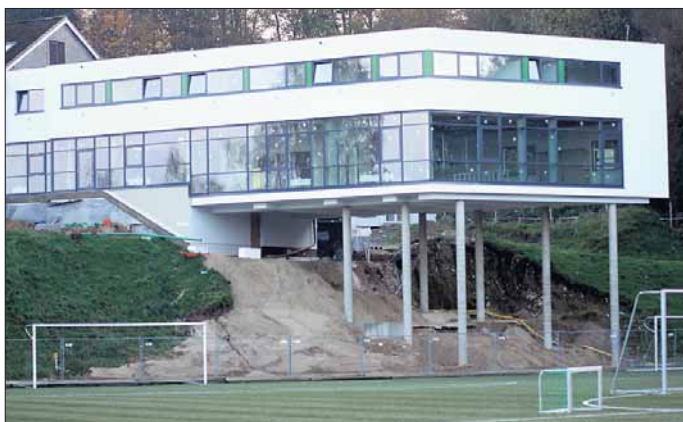
Ein Highlight im neuen Jahr wird die Neueröffnung des Uwe Seeler Fußball Parks in Malente sein. Die Ausmaße des modernen Anbaus sind jetzt schon erkennbar.
