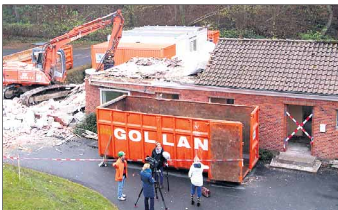
Ein Blick von oben auf den ersten Schritt der Abrissarbeiten in Malente. Vor der Baustelle dreht der NDR zusammen mit Sportschulverwalter Klaus Jespersen einen Bericht für das „Schleswig-Holstein-Magazin“.
